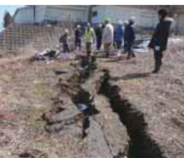
【北側法面の崩れ】
